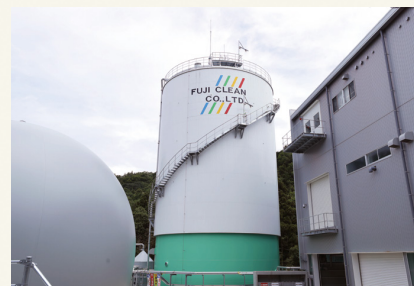
「KURITA DRANCO PROCESS®」を導入した メタン発酵施設
