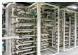
RO (逆浸透) 膜装置
